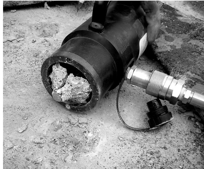
Figura 12. Martino idraulico di estrazione e coni di calcestruzzo estratti (Arch. G. Stagno, STD Genova)
